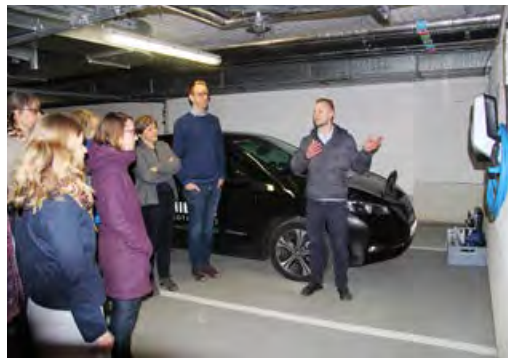
Kammereigene Ladestation geht in Betrieb
