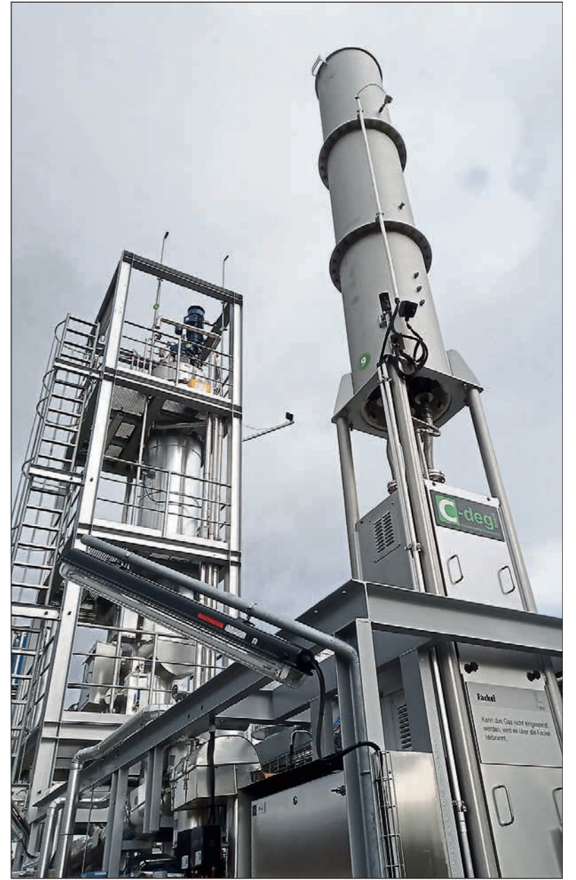
Eine Methanisierungsanlage – links steht senkrecht der Bioreaktor, in dem Wasserstoff und CO2 zu Methan reagieren. FOTO: ELECTROCHAEA GMBH
