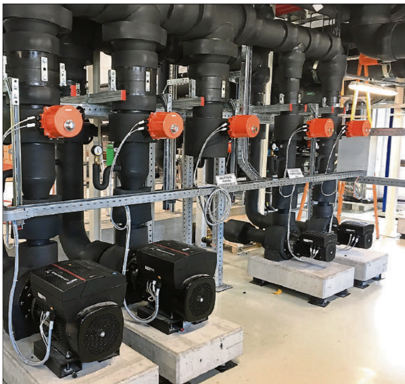
Intelligente Regelung spart Pumpenstrom.
